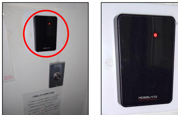
PC 教室外入口付近に設置
