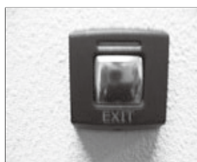
退室ボタン(5号館・2号館)
